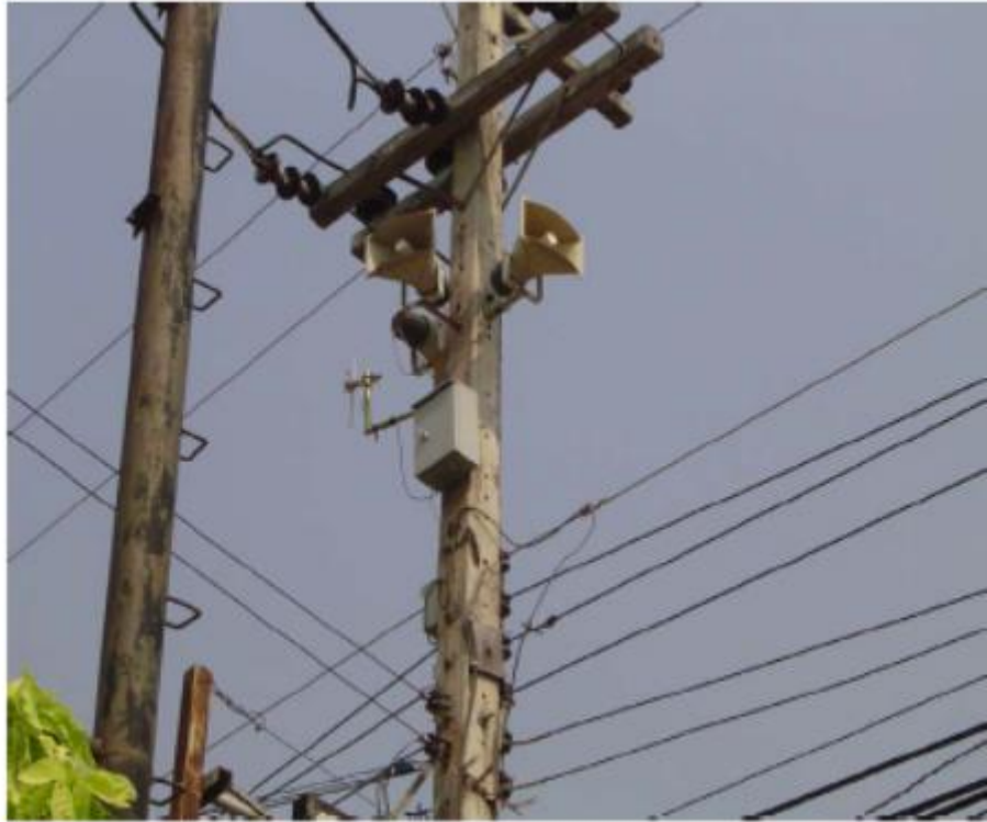
ภาพที่ 3.2 จ ลำโพงเครื่องรับสัญญาณ และสายอากาศของหอกระจายข่าวแบบไร้สายอัตโนมัติ
